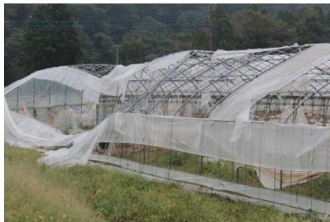
◀ ハウスの被害の様子
